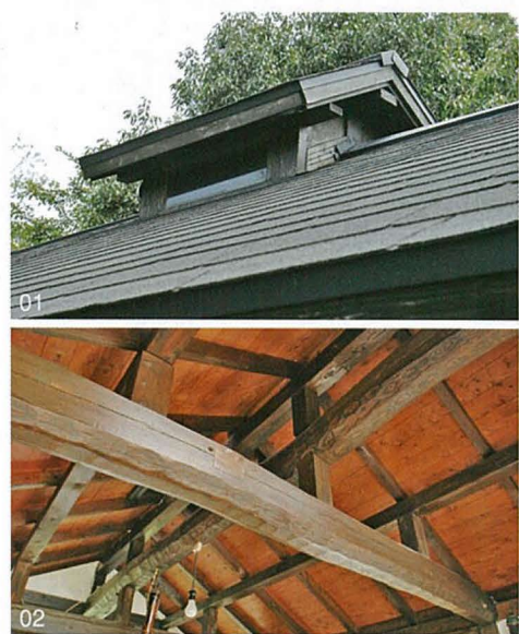
01 囲炉裏を製作するにあたり、換気をよくするためにつけられた越屋根。内部には小さな換気扇がついている。 02 山小屋を解体し、再利用された梁は見事な存在感。ホゾノミとカナヅチでコソコソ加工したという
